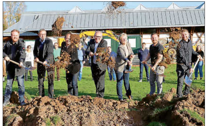
Simon Mittner (Drees & Sommer), Kämmerer Wolfgang Steiger, Architekt Tom-Philipp Zoll, Bürgermeister Bernhard Richter, Bauamtsleiterin Angelika Hollatz, Florian Graf (K&K Ingenieurgesellschaft) und Timm Pauli (Wolf und Goebel) geben den Startschuss zum Bau der Sporthalle in unmittelbarer Nachbarschaft zur Brühlhalle
