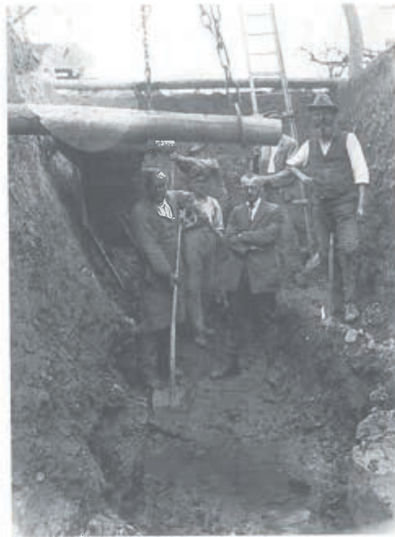
Quellfassung in den Steetwiesen beim Bau der Gemeindewasserleitung 1927. In der Mitte Schultheiß Gühle
